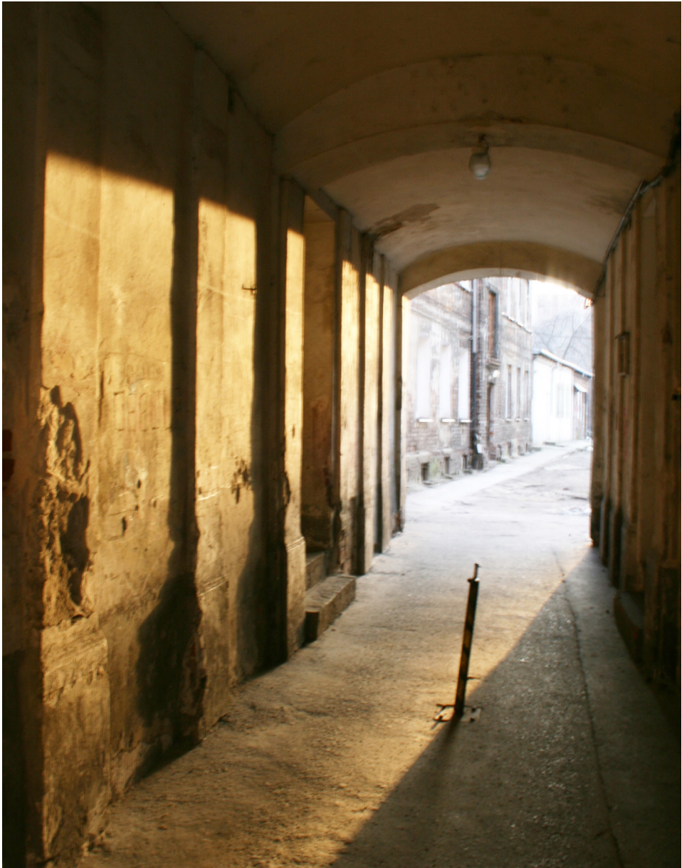
Fot. 1. Brama od ul. Brzeskiej prowadząca na jedno z podwórek, stołeczna Praga, lata 2004–2021. Źródło: materiały własne Stowarzyszenia GPAS.
