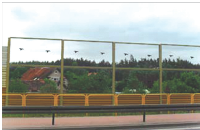
Fot. 1. Przykład nieprawidłowych zabezpieczeń przed kolizjami zastosowanych na ekranach akustycznych – zbyt małe rozmiary podobizn ptaków, rysunki w zbyt dużych odległościach od siebie
